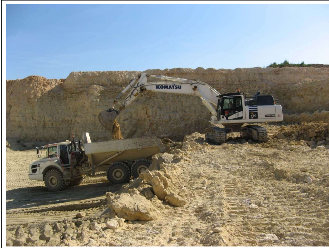
Chargement des matériaux extraits sur un tombereau qui les achemine vers le poste de prétraitement (scalpage) implanté à proximité de la zone en cours d'exploitation.
